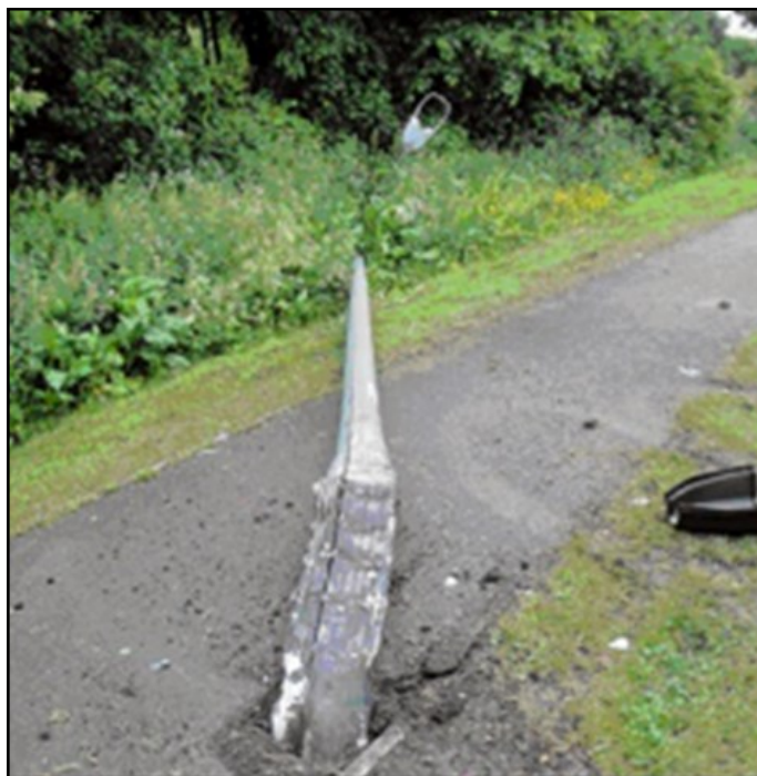
Billedet viser en KAPU "HE" mast efter påkørsel. Det fremgår tydeligt at masten bliver i sit fundament, afbøder og bringer køretøjet til standsning på en kontrolleret måde. Jævnfør VD's opdeling af mastetyper.
